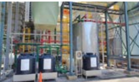
鹿港平板廠廢熱回收蒸氣鍋爐
