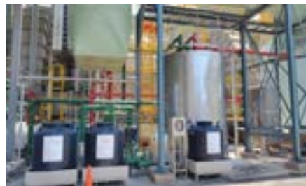
鹿港平板廠廢熱回收蒸氣鍋爐
